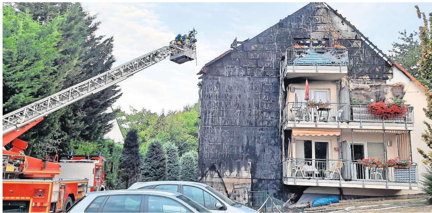
Die Spuren des Feuers sind deutlich zu erkennen: Ein Mülltonnenbrand ist über die Polystyrol-Dämmung der Fassade aufs Dach übergegangen.
