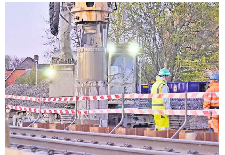
Im Licht von Scheinwerfern geht es an die Arbeit – teilweise müssen die Oberleitungen dafür ohne Strom auskommen.
